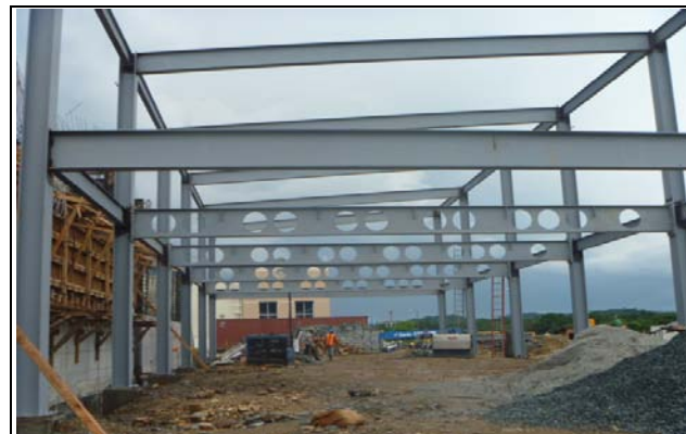
VISTA DE LA ESTRUCTURA METALICA DEL EDIFICIO OPERATIVO FALTANDOLE LAS TRABES SECUNDARIAS
