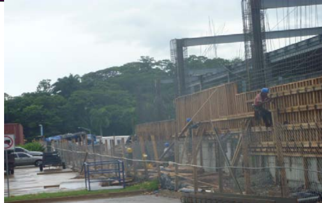
VISTA DE EL MURO PERIMETRAL DE CONCRETO DEL EJE 8 / G CIMBRANDO PARA EL PRIMER ETAPA DE COLADO
